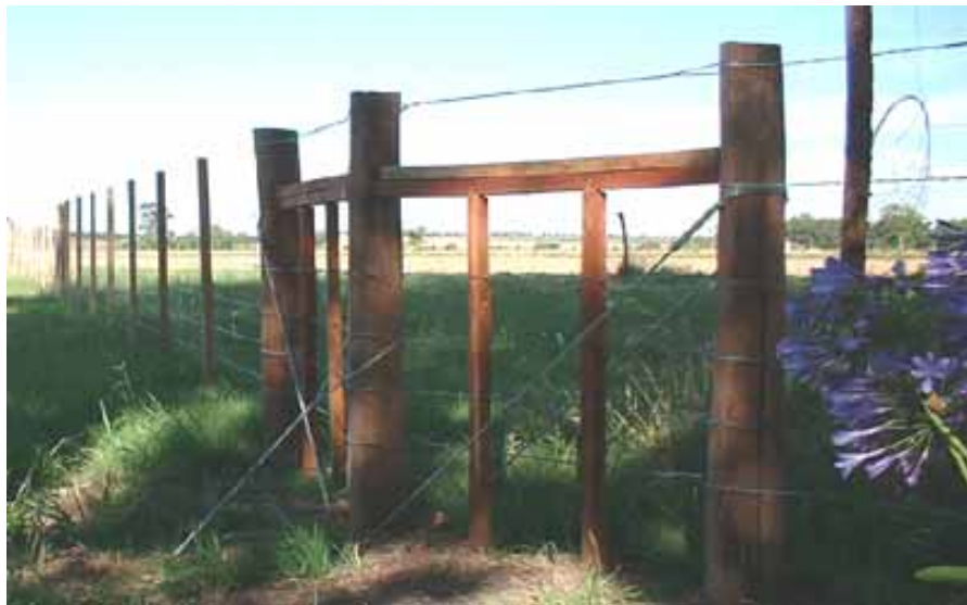
Arranque itermedio doble en ángulo de 150^\circ para línea de seis hilos, con rienda externa en el poste central.
