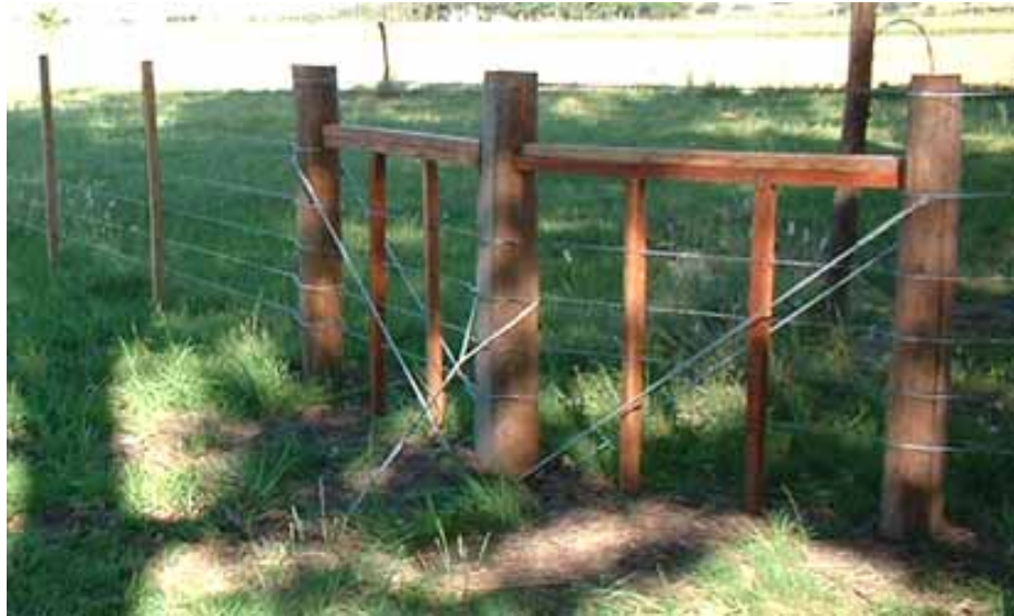
Arranque intermedio doble en ángulo de 150° para línea de seis hilos, con rienda externa en el poste central.
